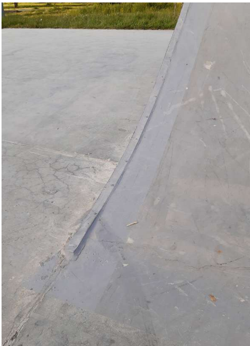
Fot.6.7.7 Nieprawidłowo osadzone i zabezpieczone ostre krawędzie
