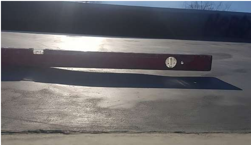
Fot.6.7.2 Nierówno zatarta nawierzchnia jezdna elementu
