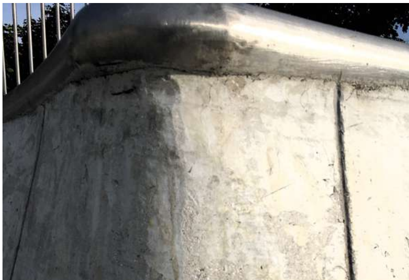
Fot.6.7.3 Błędne osadzenie Copingu
