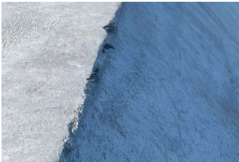
Fot.6.7.5 Odpryski betonu na krawędziach
