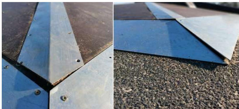
Fot.7.7.8 Błędna instalacja stalowych okuć przeszkód skateparku
