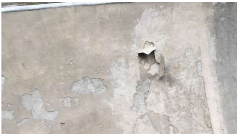
Fot.6.7.6 Odpadająca szpachlówka
